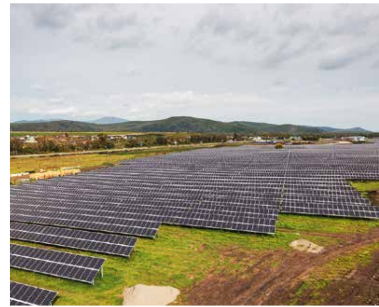
Солнечная электростанция расположена на территории двух площадок, непосредственно прилегающих к аэропорту Горно-Алтайска, и занимает площадь 68,5 га
